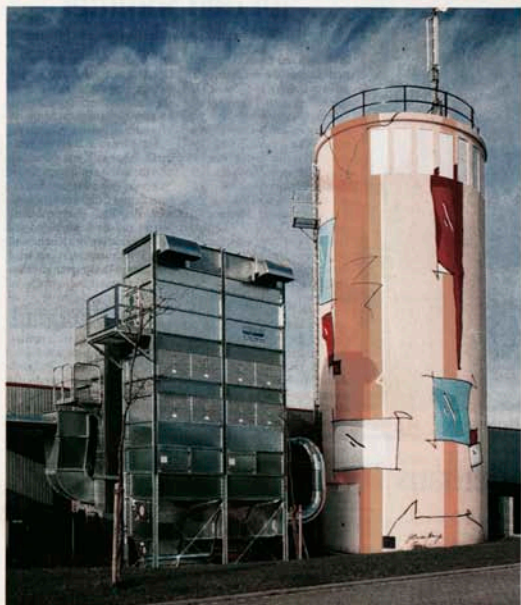
1. Preis Gewerbebetrieb: Auch technische Gebäude sollten farbig zu Ende gedacht werden, so die Jury. 1.500 Euro gab es daher für die Giesguth GmbH. Ausführender Betrieb: Malermeister Ahle, Paderborn.
